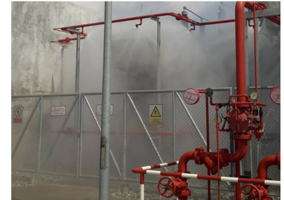
防火システム
