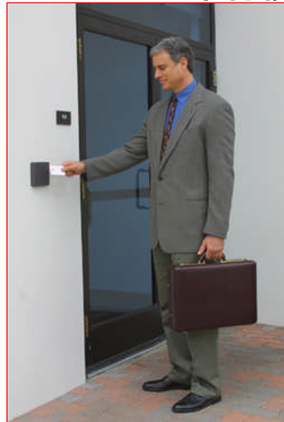
入退室管理システム
