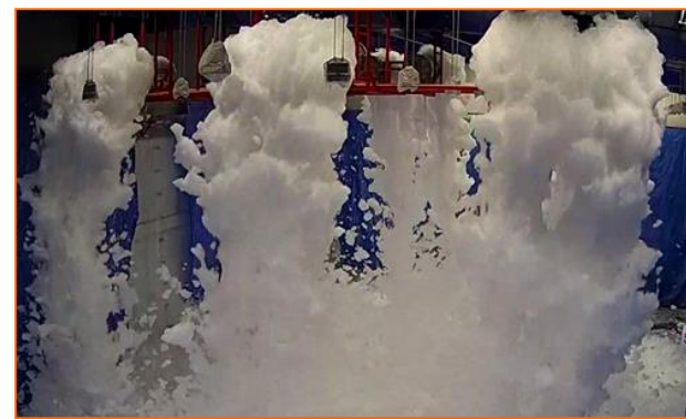
防火システム(泡消火設備)
